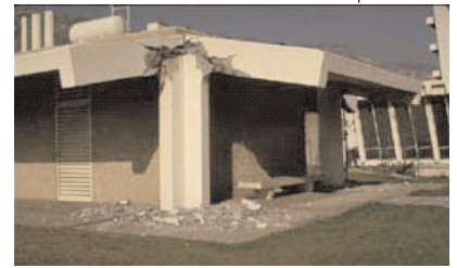
Fig. 8 - Rupture d'un auvent en porte-à-faux (séisme de San Fernando, Californie, 9 février 1971)
