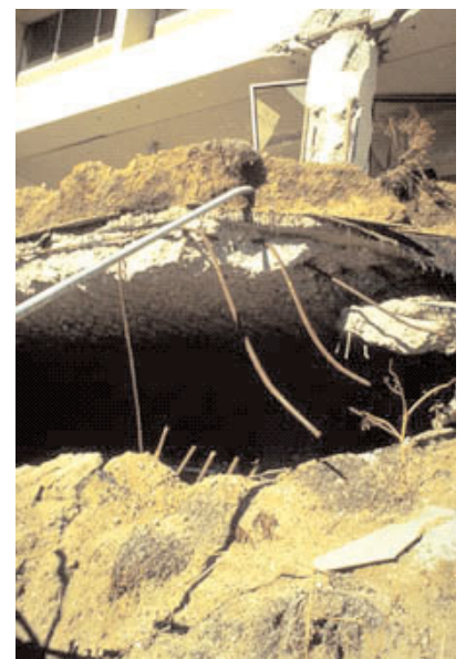
b) Toiture-terrasse végétalisée portée par des portiques en béton armé, dont les poteaux ont été cisailés
