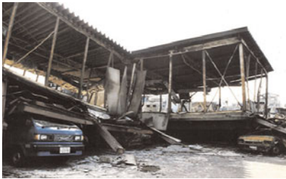
Fig. 11 - Effondrement d'un bâtiment dont le rez-de-chaussée n'était pas suffisamment contreventé (séisme de Kobé, Japon, 17 janvier 1995)
