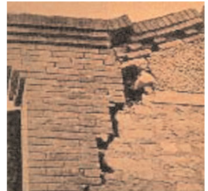
Fig. 15 - Rupture d'un mur hétérogène (séisme de Tangshan, Chine, 28 juillet 1976)
