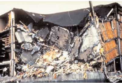
Fig. 13 - Effondrement d'un bâtiment par torsion en raison d'une disposition asymétrique des murs assurant le contreventement (séisme d'Anchorage, Alaska, 27 mars 1964)
