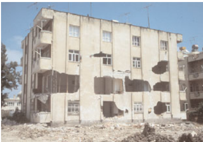
Fig. 19 - Bâtiment endommagé lors de l'effondrement d'une construction voisine (déblayée avant la prise de la photo), séisme de Ceyhan-Misis, Turquie, 27 juin 1995
