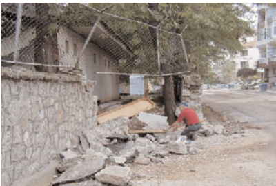
b) Décrochement horizontal de 3 m qui, par chance, s'est produit à côté de la construction (séisme d'Izmit, Turquie, 17 avril 1999)
