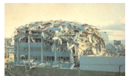
Fig. 17 - Dommages dus à la résonance du bâtiment avec le sol (Mexico, séisme du Mexique, 19 septembre 1985)
