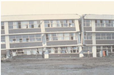
Fig. 14 - Dommages dus à l'entrechoquement de deux blocs de bâtiment séparés par un joint de dilatation thermique (séisme de Tokachi-Oki, Japon, 16 mai 1968)
