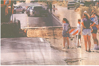
a) Décrochement vertical et horizontal (séisme de Loma Prieta, Californie, 17 octobre 1989)
