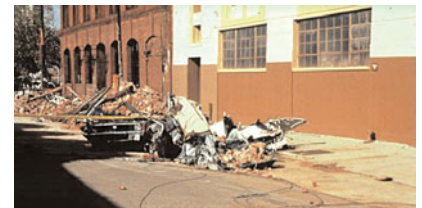
Fig. 16 - La chute de briques de parement lors du séisme de Loma Prieta, Californie, 17 octobre 1989. Cinq personnes ont été tuées dans une voiture en stationnement
