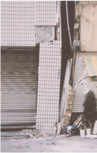
Fig. 18 - Dommages dus à l'entrechoquement de bâtiments voisins (séisme de Kobé, Japon, 17 janvier 1995)
